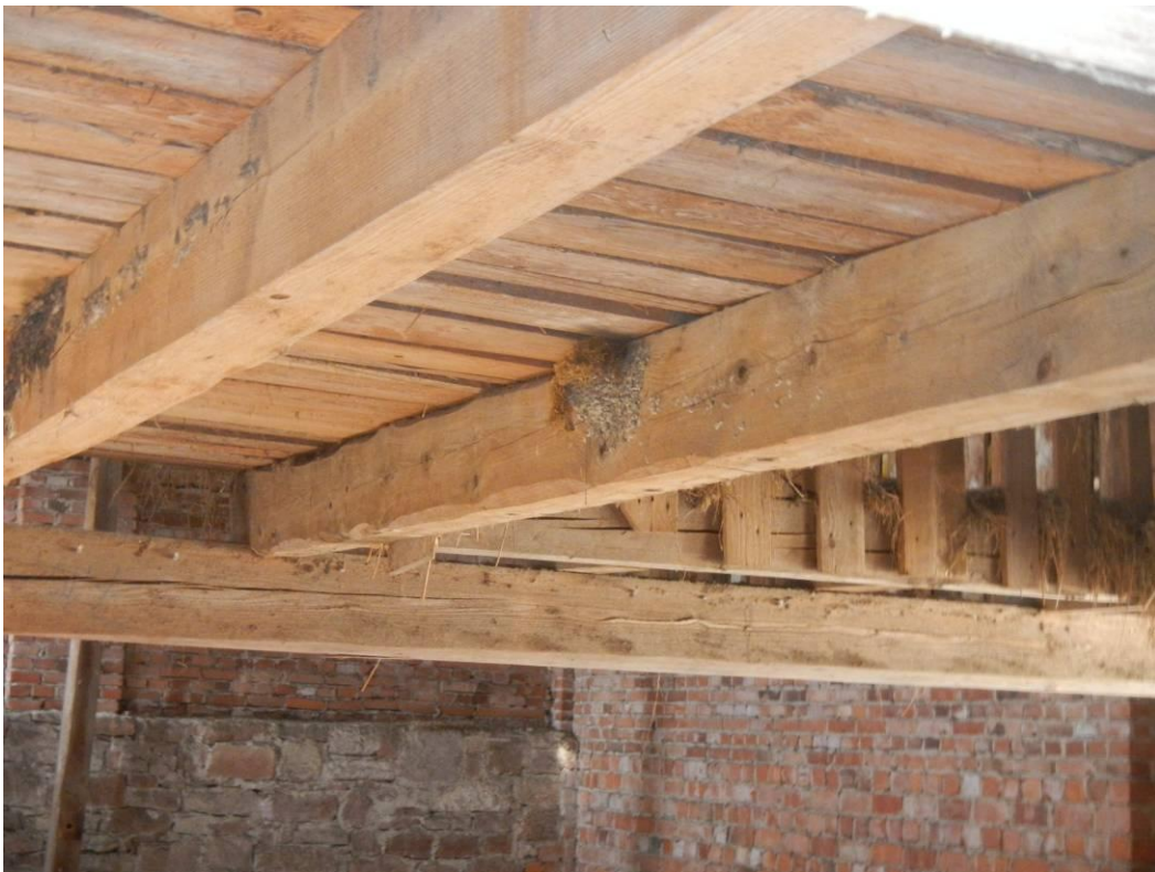
Abbildung 7: Rauchschalbennest in bestehendem Gebäude im nördlichen Teilbereich (Foto: S. Hund, 08.07.2020)
